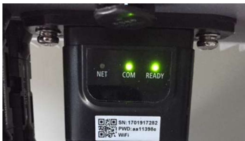
Figura 64 - Estado inicial de los led
