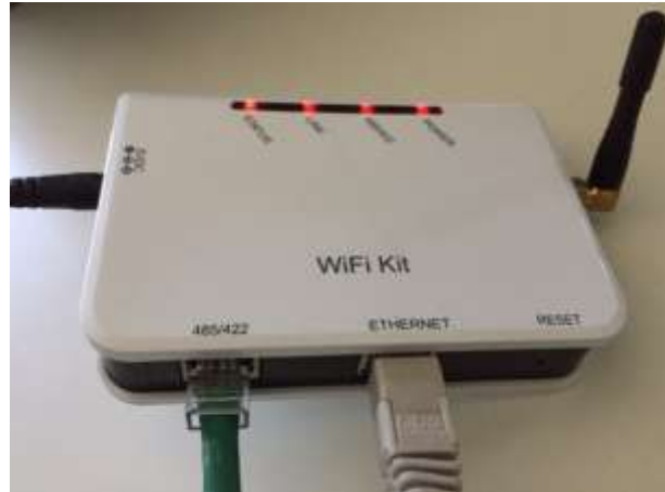
Figura 82 - Cable ethernet conectado al datalogger
