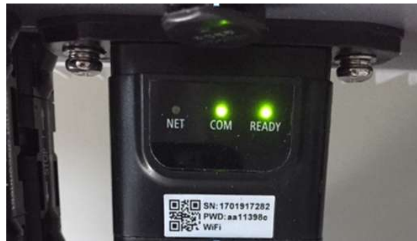
Figura 70 - Estado inicial de los led
