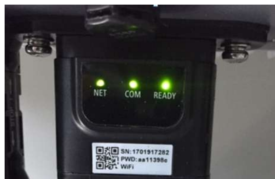
Figura 71 - Estado final de los led
