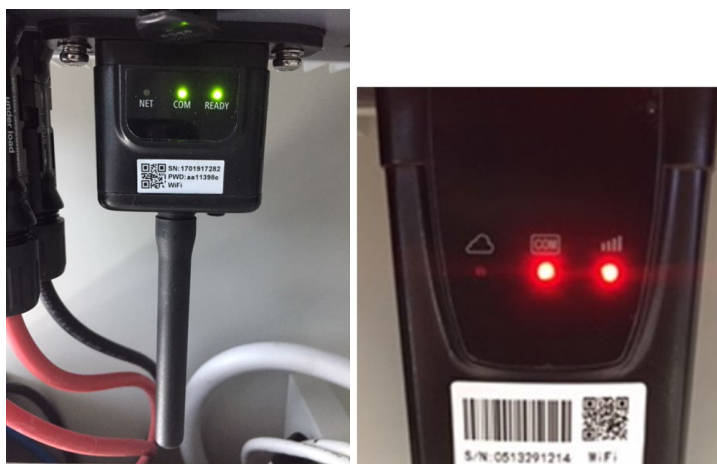
Figura 59 - Estado inicial de los LED
