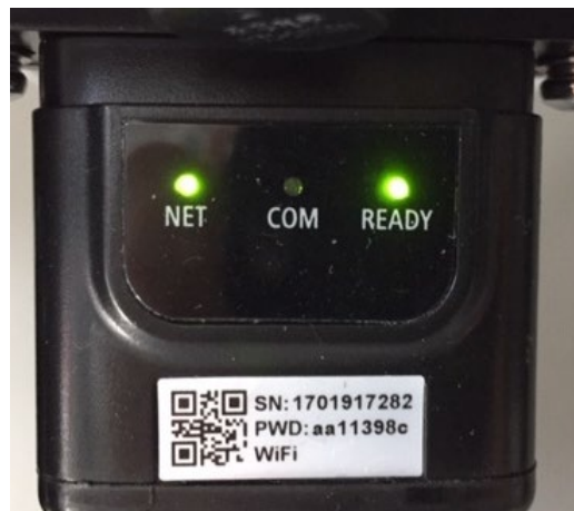
Figura 72 - Estado de comunicación irregular entre inversor y adaptador
