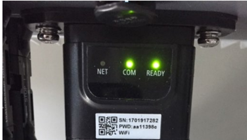
Figura 70 - Estado inicial de los LED
