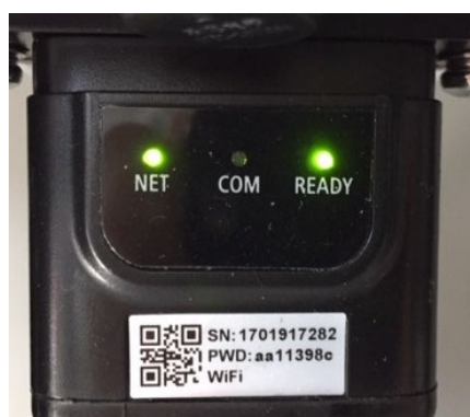
Figura 78 - Estado de comunicación irregular entre inversor y adaptador
