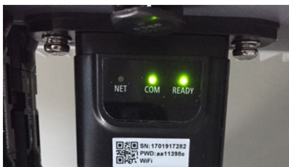
Figura 76 - Estado inicial de los LED
