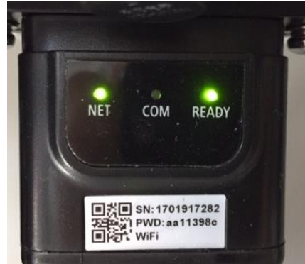
Figura 74 - Estado de comunicación irregular entre inversor y adaptador
