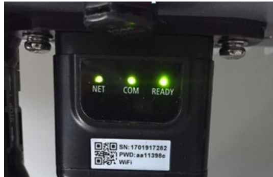
Figura 73 - Estado final de los LED
