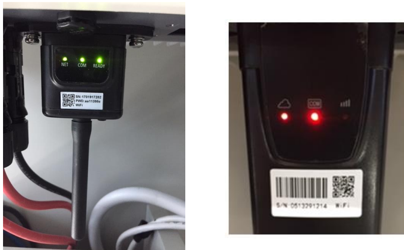
Figura 55 - Estado final de los LED
