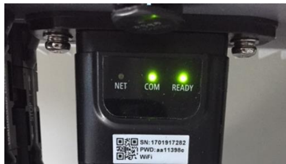
Figura 72 - Estado inicial de los LED
