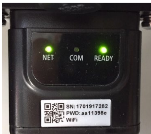
Figura 133 - Estado de comunicación irregular entre inversor y tarjeta
