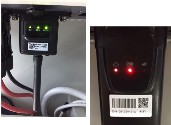
Figura 120 - Estado final de los led
