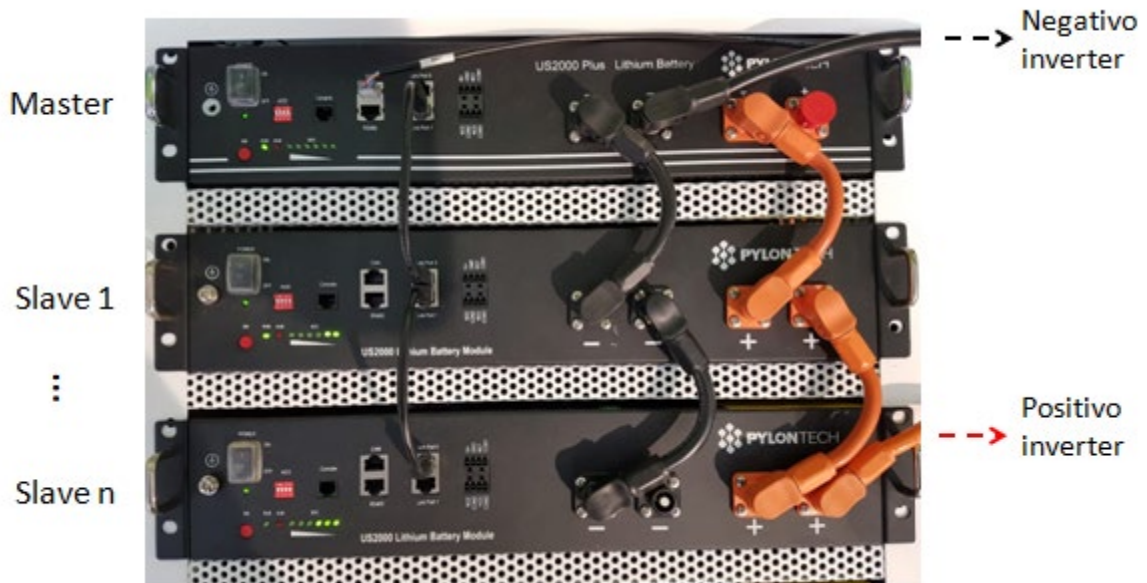
Figura 15 - Conexión de tres baterías Pylontech en paralelo
