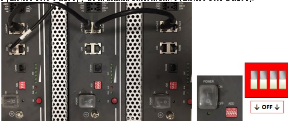
Figura 14 - Conexión del cable de comunicación entre tres baterías Pylontech
