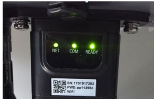
Figura 138 - Estado final de los led
