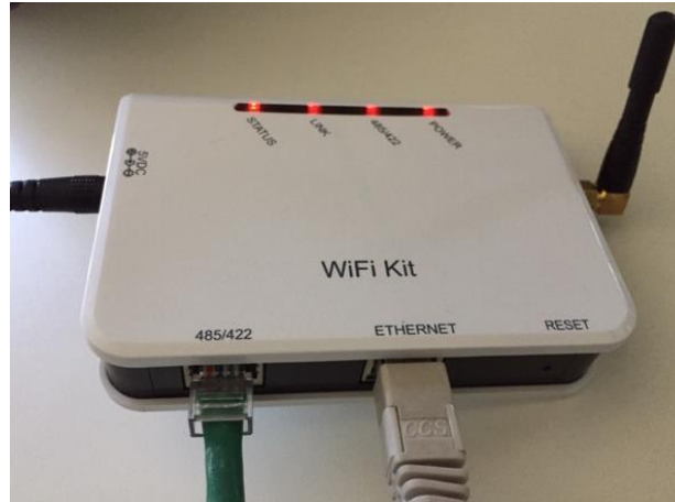
Figura 93 - Cable ethernet conectado al datalogger
