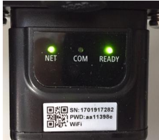
Figura 77 - Estado de comunicación irregular entre inversor y tarjeta
