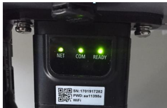
Figura 82 - Estado final de los led
