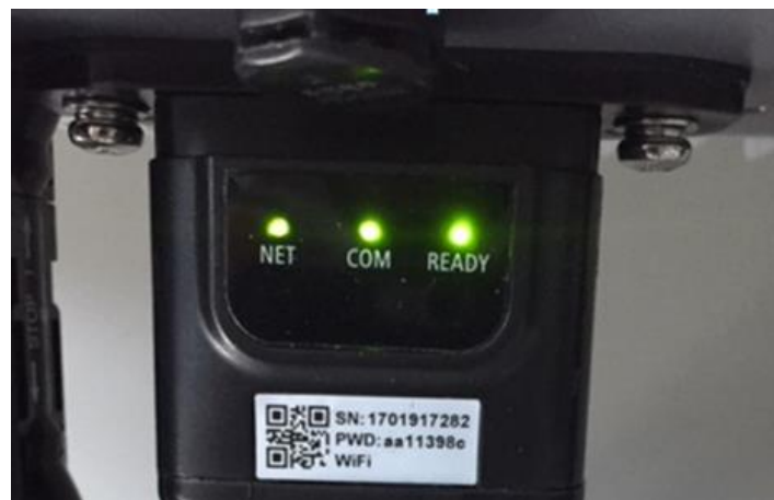
Figura 76 - Estado final de los led
