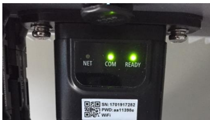
Figura 64 - Estado inicial de los led
