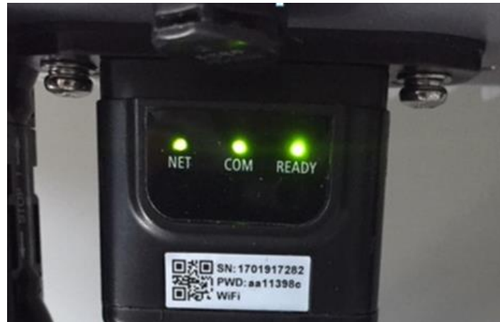
Figura 65 - Estado final de los led
