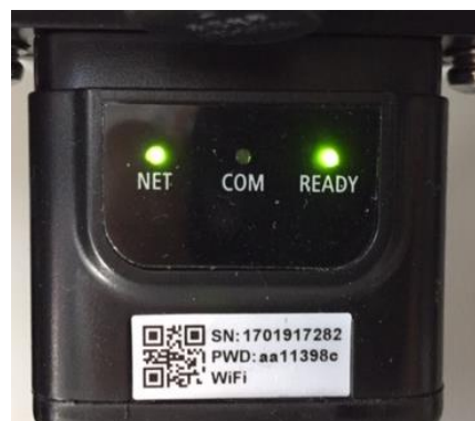
Figura 72 - Estado de comunicación irregular entre inversor y tarjeta
