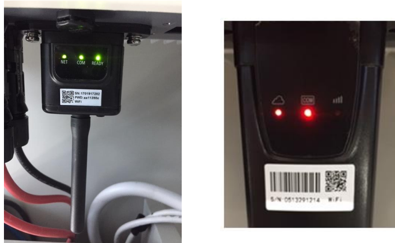
Figura 53 - Estado final de los led
