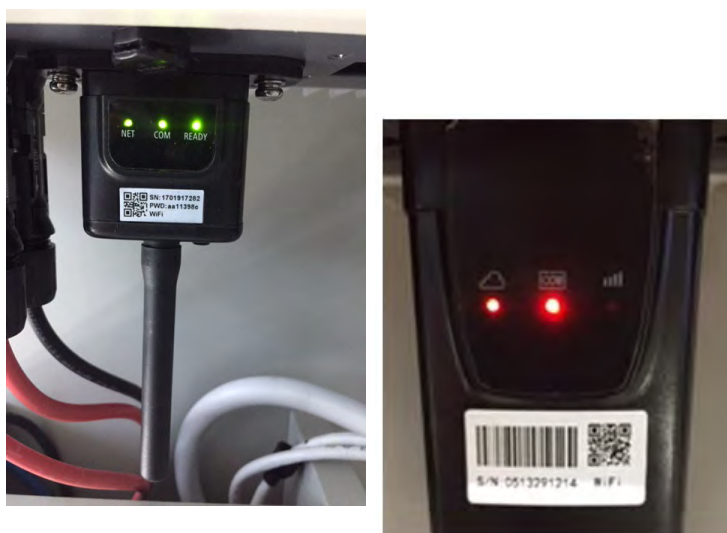
Figura 77 - Estado final de los LED
