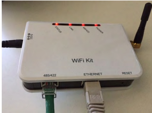
Figura 92- Cable Ethernet conectado al datalogger
