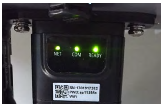
Figura 95 - Estado final de los LED
