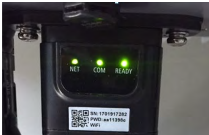
Figura 89 - Estado final de los LED
