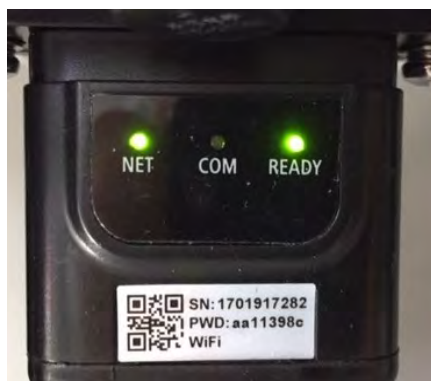
Figura 96 - Estado de comunicación irregular entre inversor y adaptador
