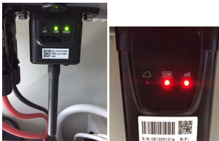
Figura 76 - Estado inicial de los LED
