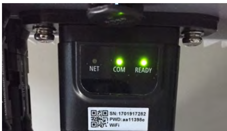
Figura 88 - Estado inicial de los LED
