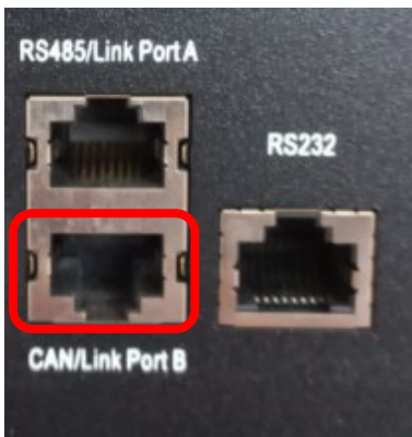
BMS SC500 y SC1000
